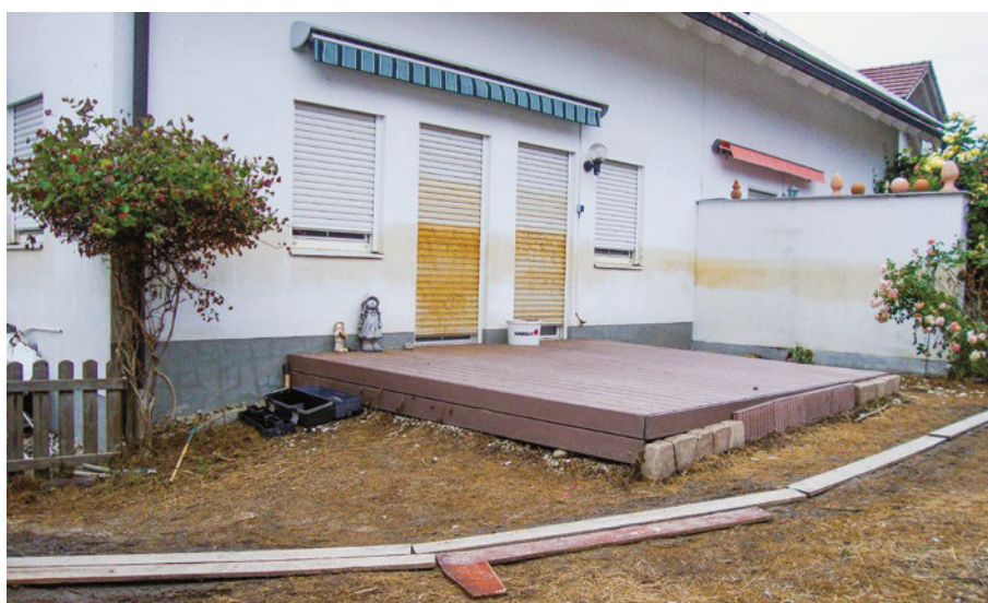
5 | Ebenfalls relevant bei der Verteilung der Schadensursachen: Flutkatastrophen
